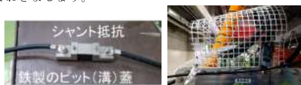
図 2-3 むき出しのままのシャント抵抗接続部で発生する地絡の例(左)、不注意な感電防止のためカバーをした電流リード接続部(右)
