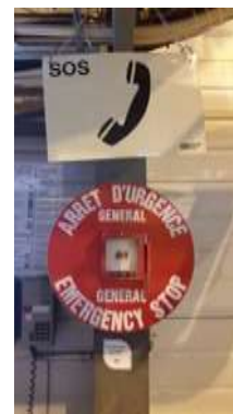
図 4-3 出入り口付近に設けられる緊急遮断ボタン
