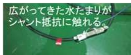
図 2-6 水溜まりによる漏電
