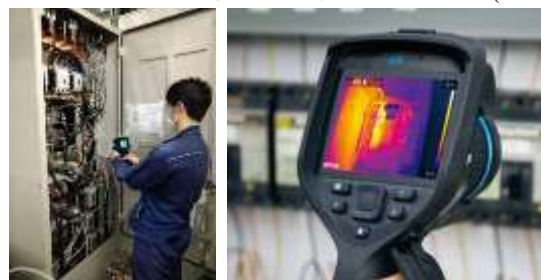
図 2-2 サーモグラフィ温度計でのケーブル温度監視。
